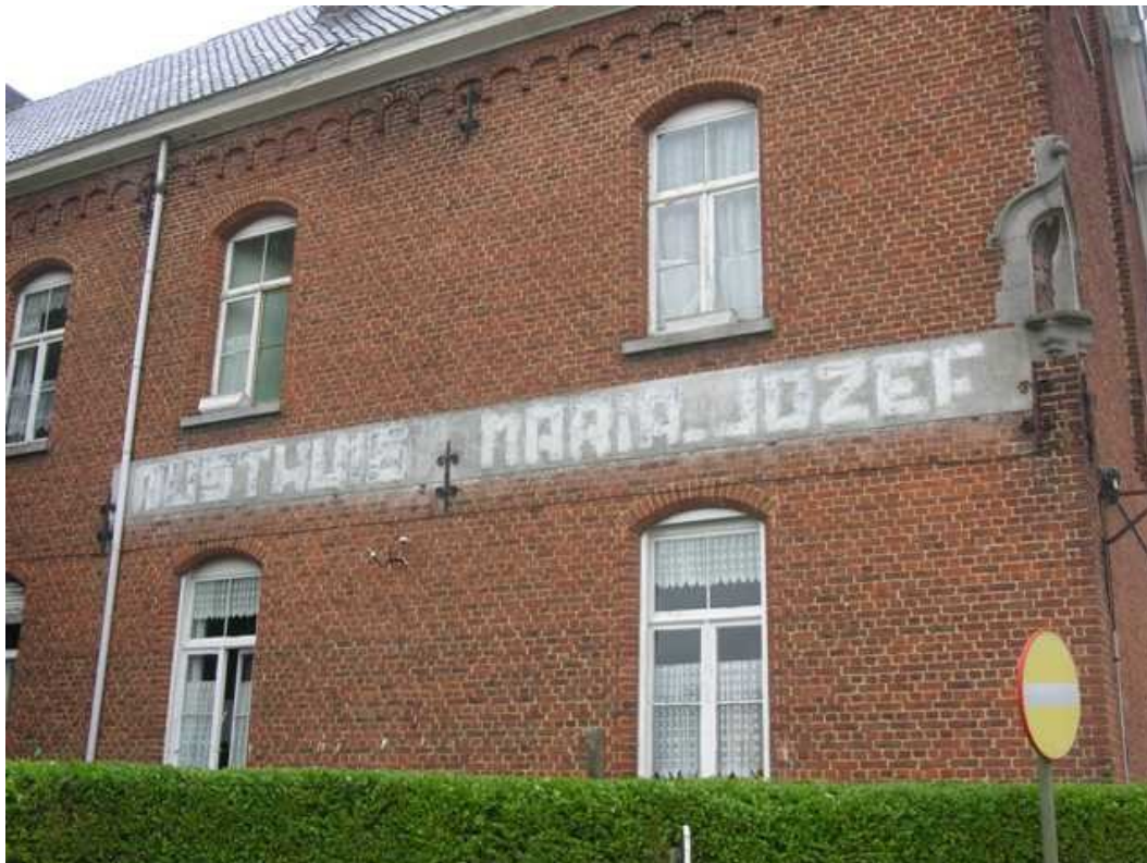
Figuur 26: Detail uit 2011 van de westelijke vleugel (rusthuis) van 1892 van het klooster (ID 159392 - https://id.erfgoed.net/afbeeldingen/159392 (CC BY 4.0))
